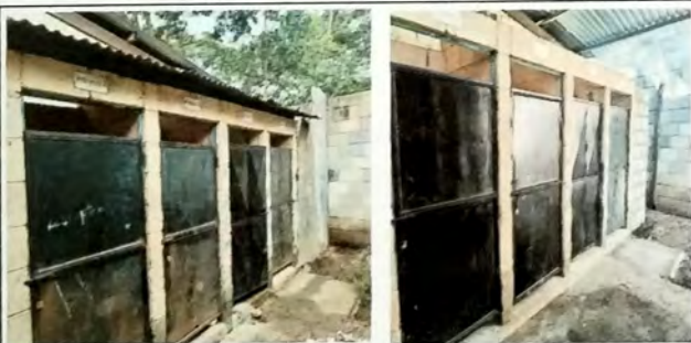
Foto 9: Vista de remozamiento de 4 puertas de metal que estaban muy dañadas.
